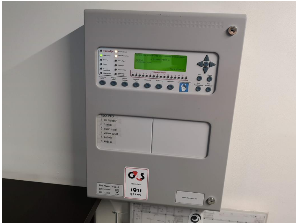
Foto. Hoone ATS keskseade.
