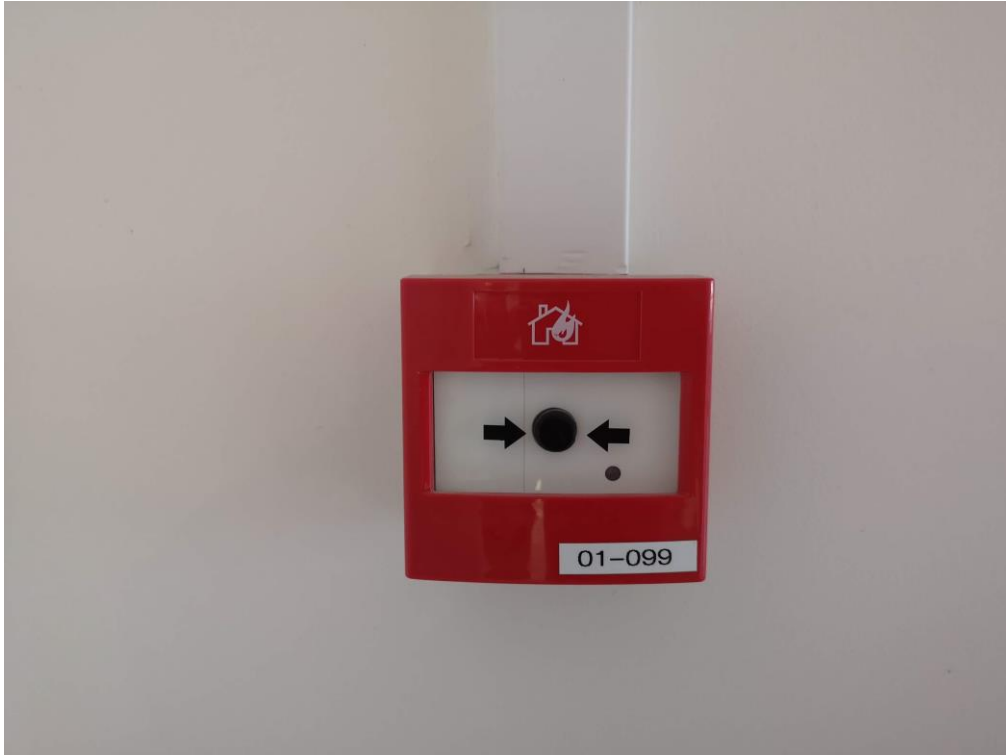
Foto. Hoone tulekahju teatenupp.
