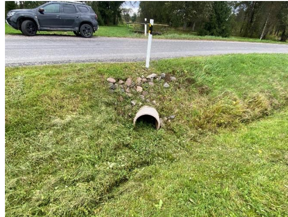
Foto 2 Vaade truubil 1 ja kraavile 12, kust suurvee ajal liigub vesi Jänese kinnistul paiknevale Kirila ehitisele.
