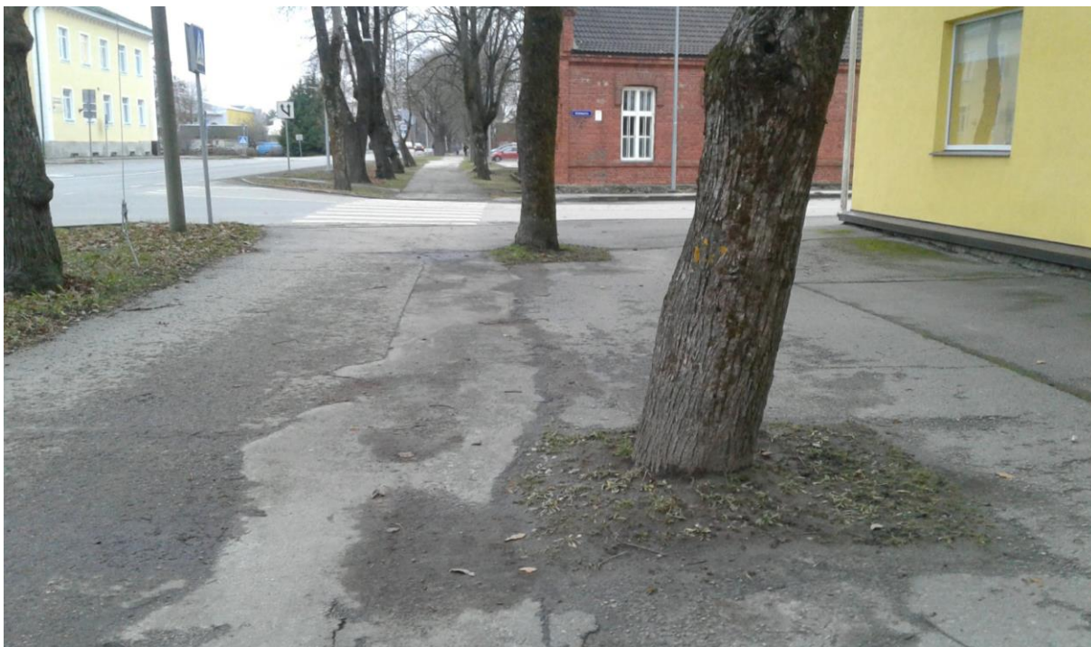
Foto 74. Näide Pärnu tn puudest, mille toitepinda on asfaltkattega märkimisväärselt kahandatud.
